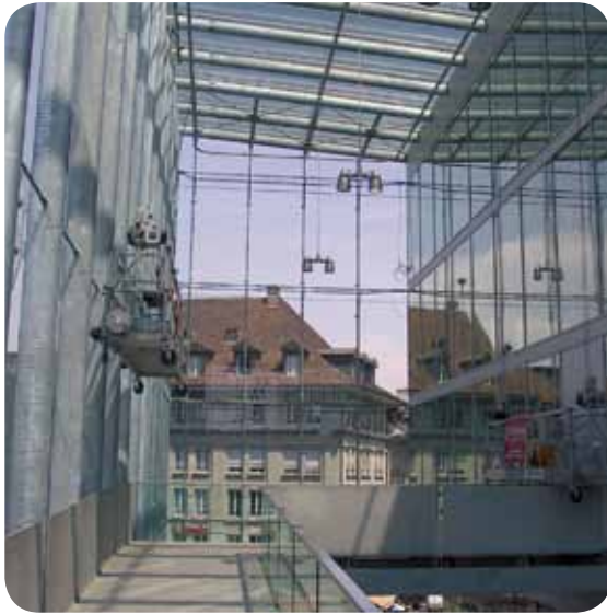
Espace couvert en verre ajouté après la construction à ce bâtiment de gare
