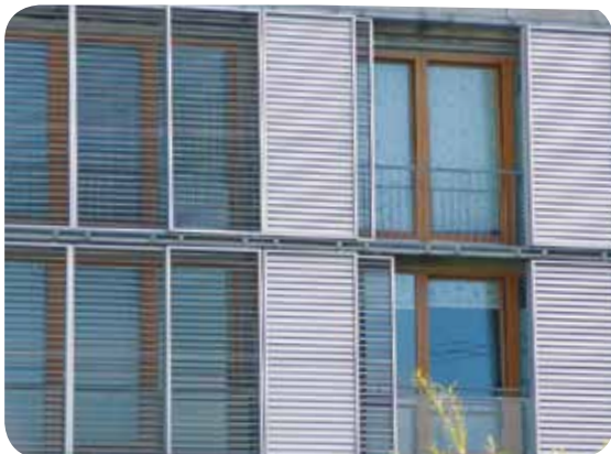
Ces stores déplaçables latéralement évitent la surchauffe et empêchent les collisions des oiseaux.
