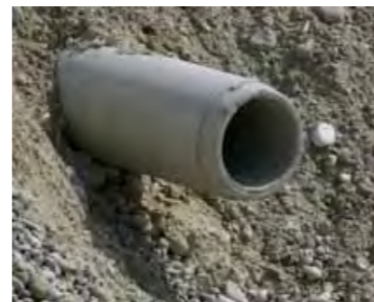
>> Buse sous la voirie inutilisable par la faune dans le sens de la remontée.
