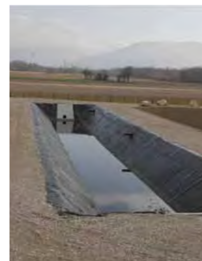
>> Bassin de décantation avec géo membrane.
