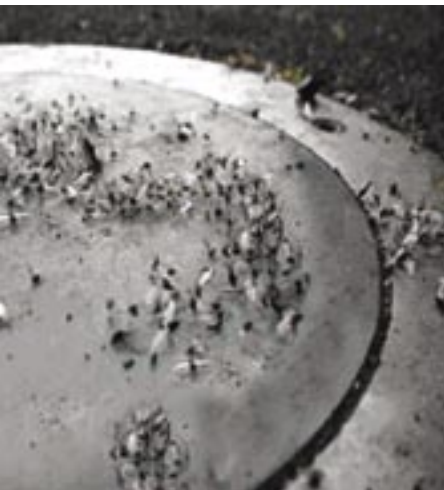
Le butin nocturne d'un projecteur encastré dans le sol.
