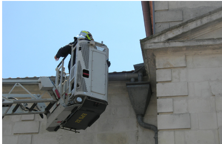
Intervention des pompiers de Rochefort aux Fonderies Royales (17)
