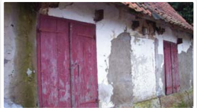
Présence de reprise en ciment, «enfermant» les échanges hygrosopiques et entraînant le pourrissement du pan de bois
