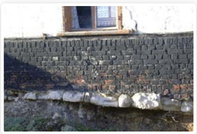
Déchaussement d'un mur
