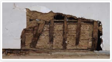
Pourrissement des bois
