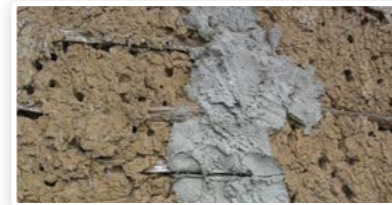
Reprise partielle en ciment, à purger
