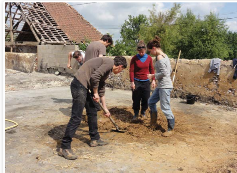
Foulage au pied du torchis. On appelle cette étape «la danse de l'artisan»
