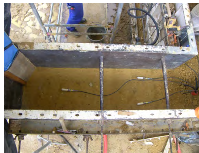
Maison de St-Antoine l'Abbaye : les sondes d'humidité relative et température (à gauche) et de teneur en eau (à droite) positionnées dans les murs en pisé.
