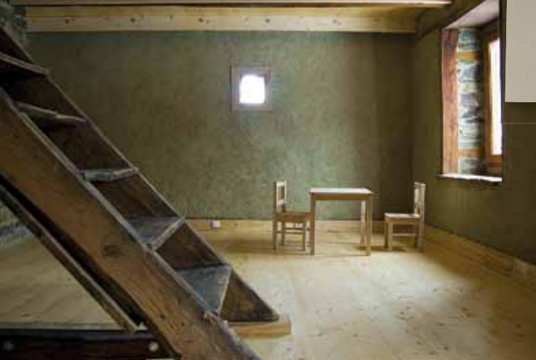
Enduit terre/chanvre servant de correction thermique dans une maison traditionnelle en pierre.
