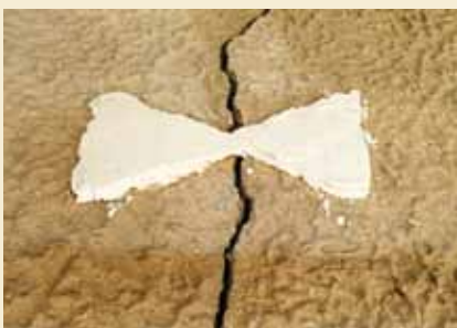
Témoin en plâtre sur une fissure
