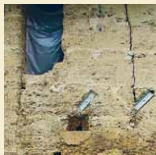
Exemples de reprise de fissure.
