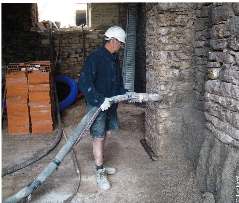
Une machine à projeter le chaux-chanvre permet des épaisseurs plus variées qu'à la main.
