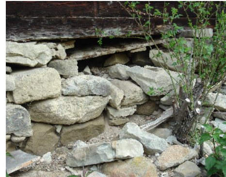
Détachement de blocs
