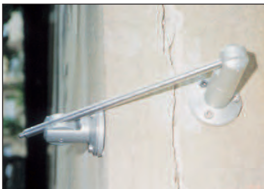
Analyse de l'évolution d'une fissuration survenant en tableau dans le plan des armatures
