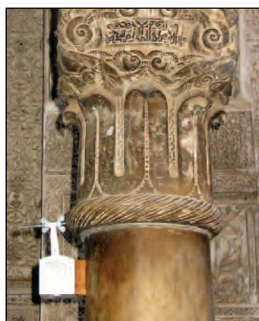
La colonne est désaxée par rapport au chapiteau suite au tremblement de terre à Fès (01.03.2004)
