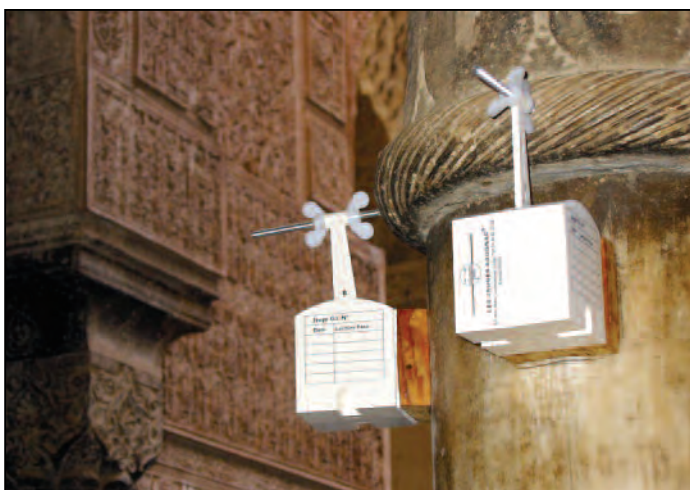
Pour mesurer l'évolution du glissement du chapiteau sur la colonne, 2 jauges G3 sont posées sur la colonne, décalées de 90°
