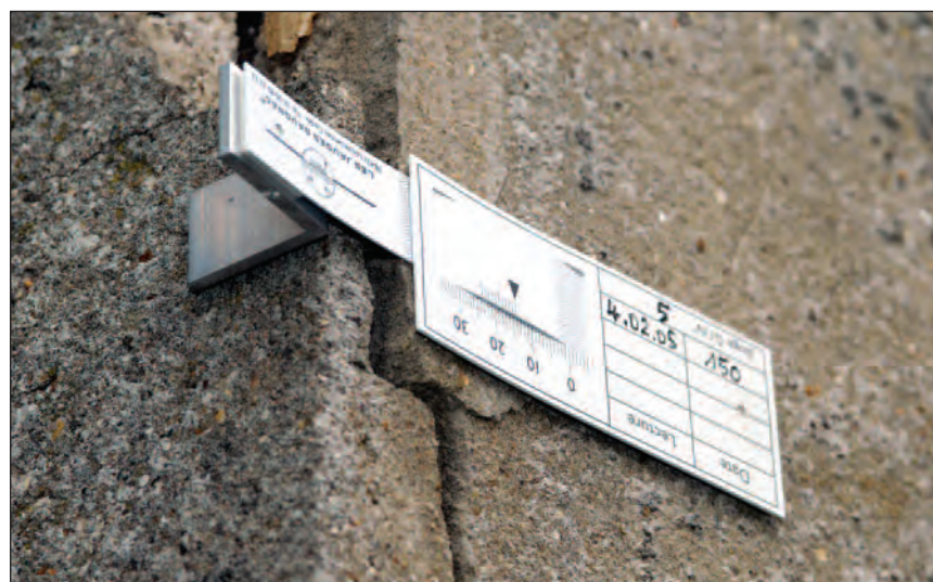
Pose d'une jauge G1 sur fissure de rive avec une cornière aluminium
